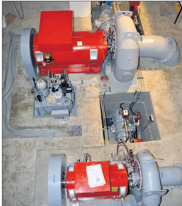
Die beiden neuen Kössler-Turbinen mit Leistungen von 1500 l/sec und 300 l/sec.
