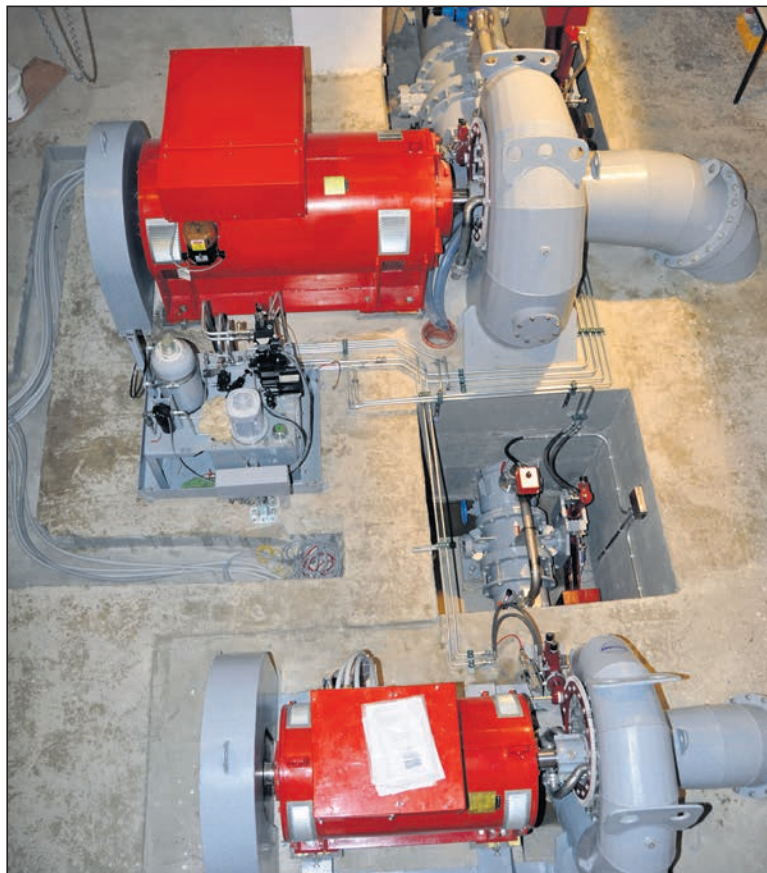
Die beiden neuen Kössler-Turbinen mit Leistungen von 1500 l/sec und 300 l/sec.
